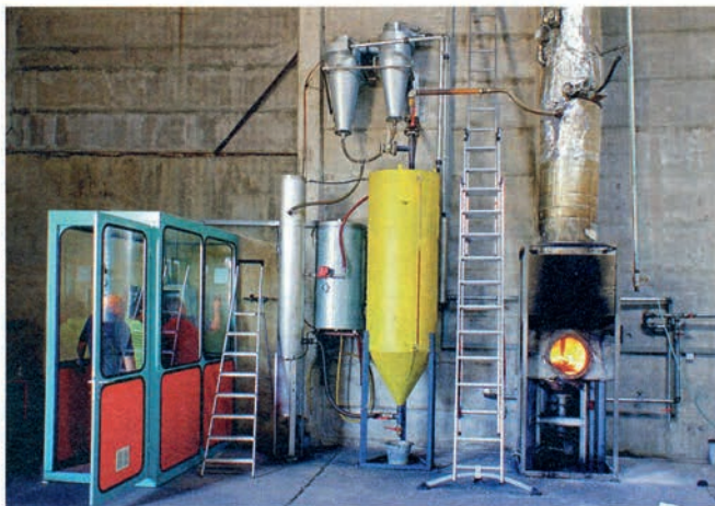
Biomassevergaser biomax mit einer variablen Leistung von 30 bis 250 Kilowatt.
